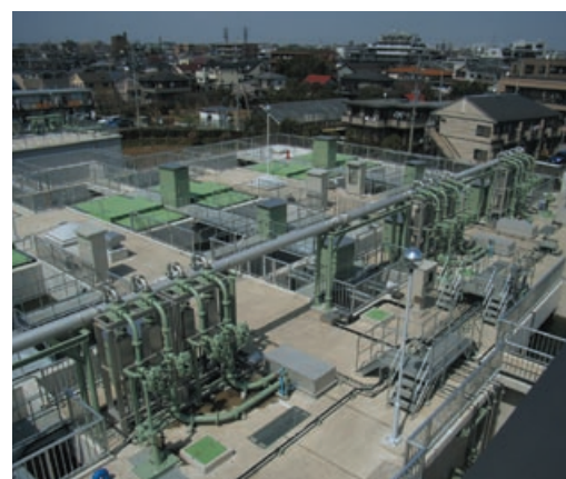
生田浄水場（川崎市）
