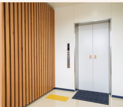
エレベーター ＊旧庁舎にはなかったエレベーターを設置するなど、バリアフリー化が図られています。
