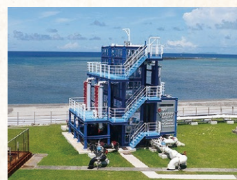
沖縄県海洋温度差発電実証試験設備 [沖縄県商工労働部産業政策課提供]
