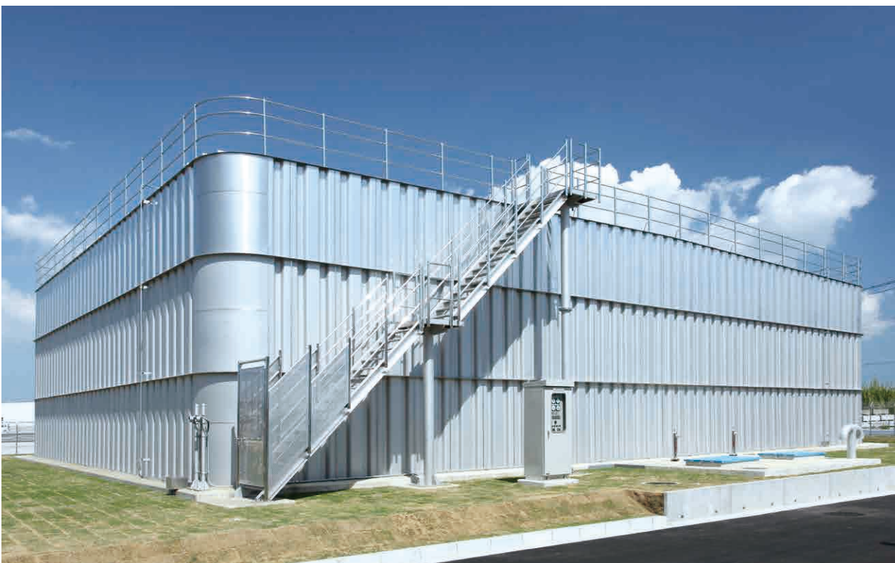
水道事業：金田配水場（千葉県木更津市）
