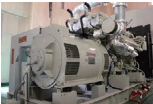
▲ 非常用自家発電機
