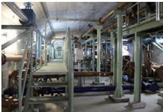
▲ 汚泥ポンプ施設
