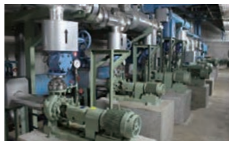
▲ 各種ポンプ施設
