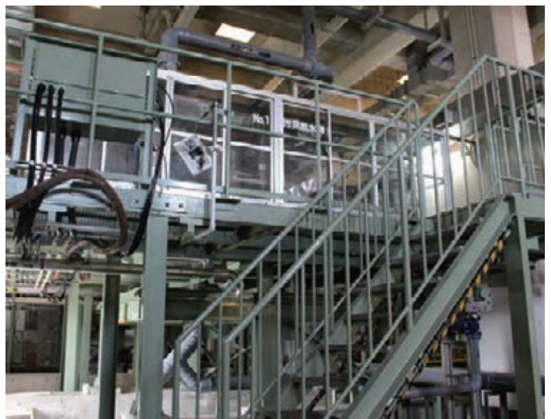
▲汚泥脱水機外観
