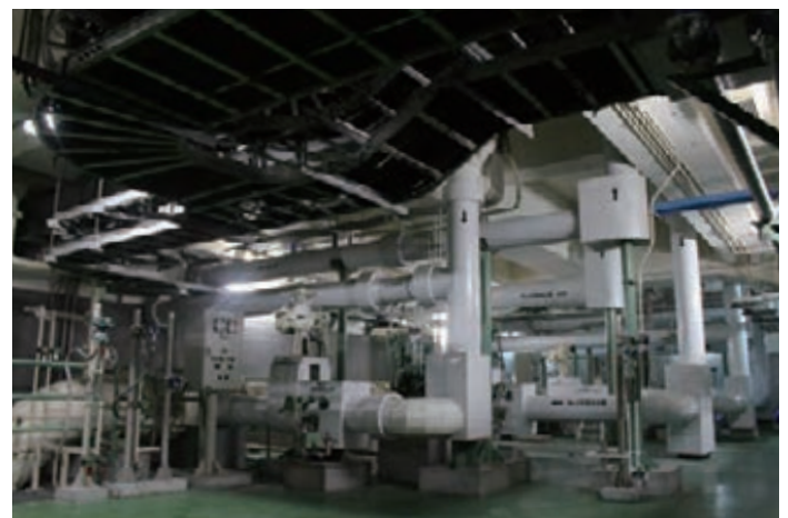
▲ 送風機地下部分
