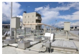
長野県飯田市 松尾浄化管理センター
