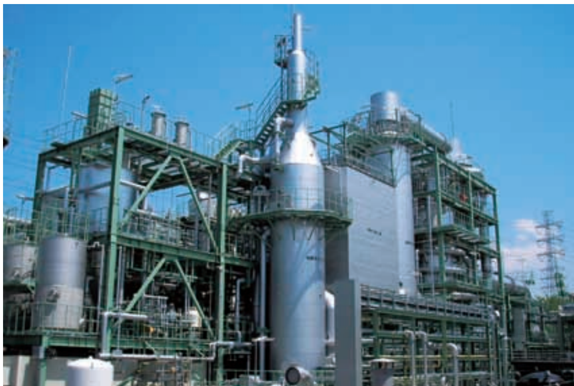
下水道事業：清瀬水再生センター下水污泥ガス化炉（東京都）
