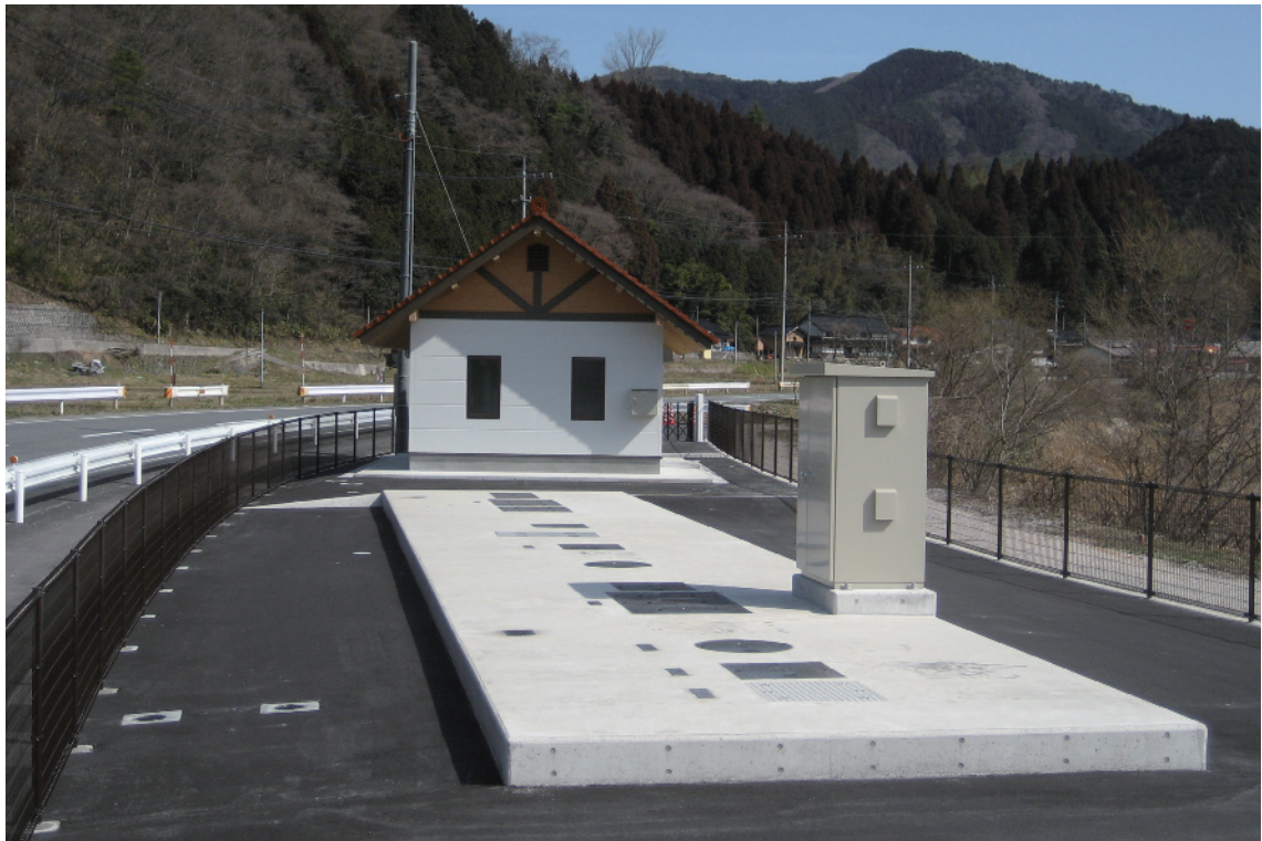
千屋浄化センター（岡山県新見市）
