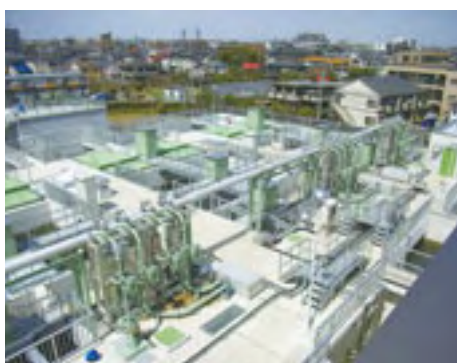
生田浄水場（川崎市）
