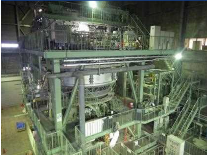
二上浄化センター3号汚泥溶融炉
