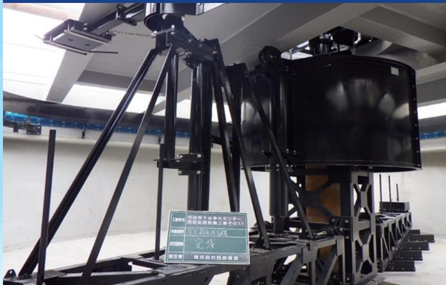
濃縮汚泥掻寄機
