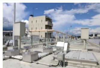
長野県飯田市 松尾浄化センター
