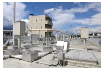
長野県飯田市 松尾浄化管理センター
