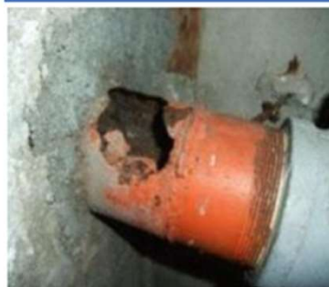
劣化による配管破損
