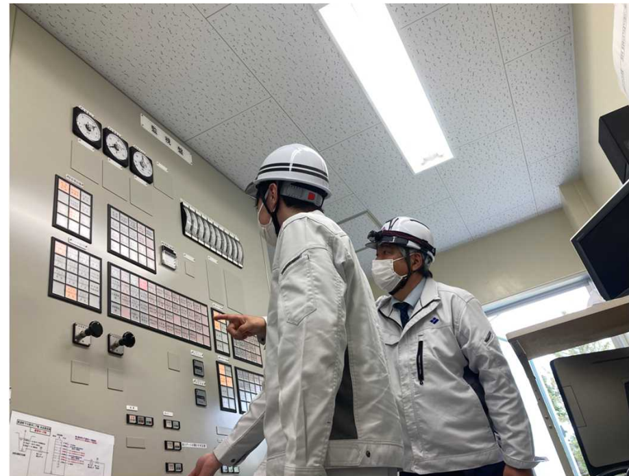
ポンプ場を職員直営で稼働
