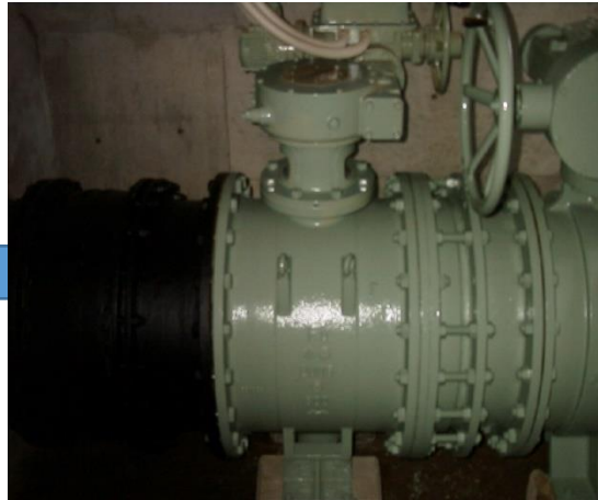
沈砂池の水位が一定となるよう 電動弁による制御
