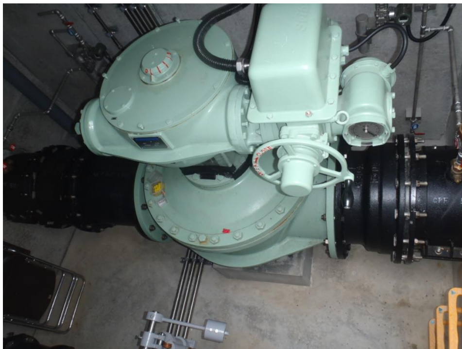
配水制御弁(コーン弁)
