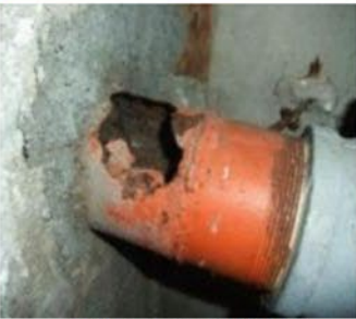
劣化による配管破損
