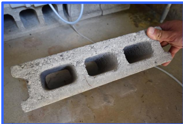
↑塩素で劣化したブロック
