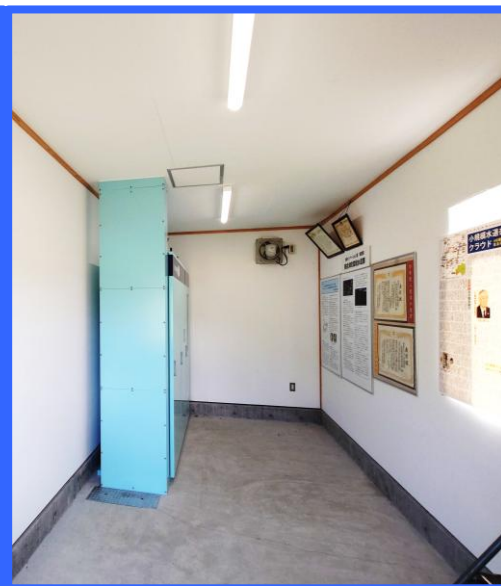
電気室 (動力計装盤)
