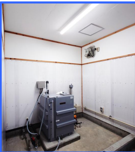
薬品室 (次亜塩素酸ナトリウム注入設備)
