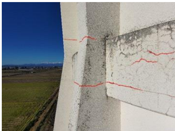
AIによりひび割れの検出例（空中）
