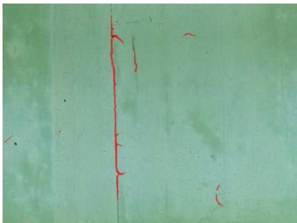
AIによりひび割れの検出例（水中）
